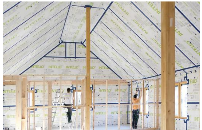
Abb. 7: Messzeitpunkt: Nach Fertigstellung der Luftdichtheitsebene im Zuge der Gewerkeabnahme. Bild: Moll pro clima
